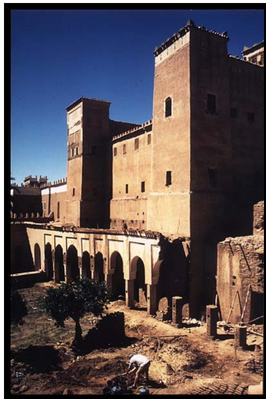
Der Arkadenhof beim Wiederaufbau 1998. Rechts die Rekonstruktion der zerstörten Säulen. Vorn ein Praktikant bei der Herstellung von Lehmziegeln.
